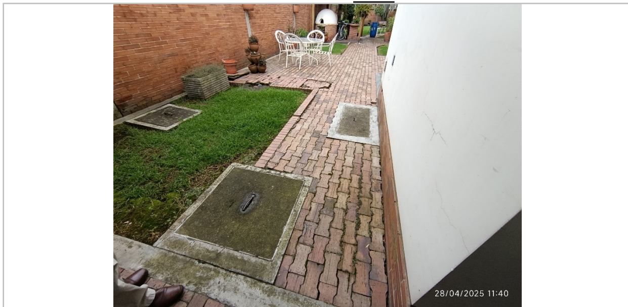
Fotografía 5. Trampa de grasas casa principal.
